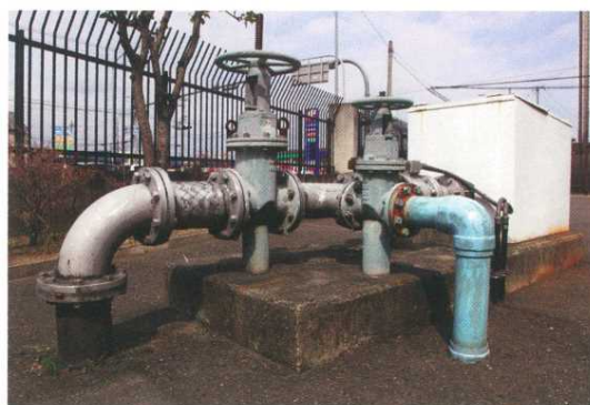
浄水場内の井戸（15号井戸）
