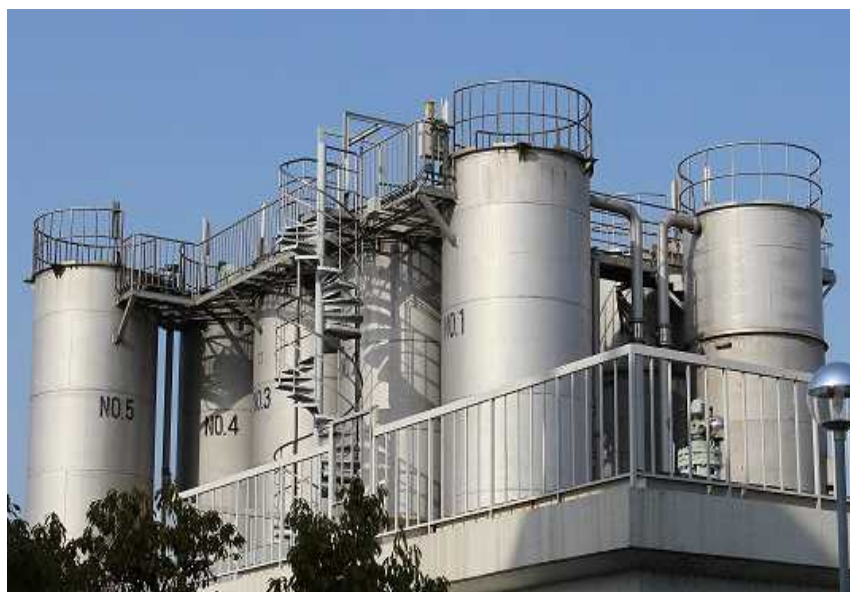
大冠浄水場のエアレーション設備
