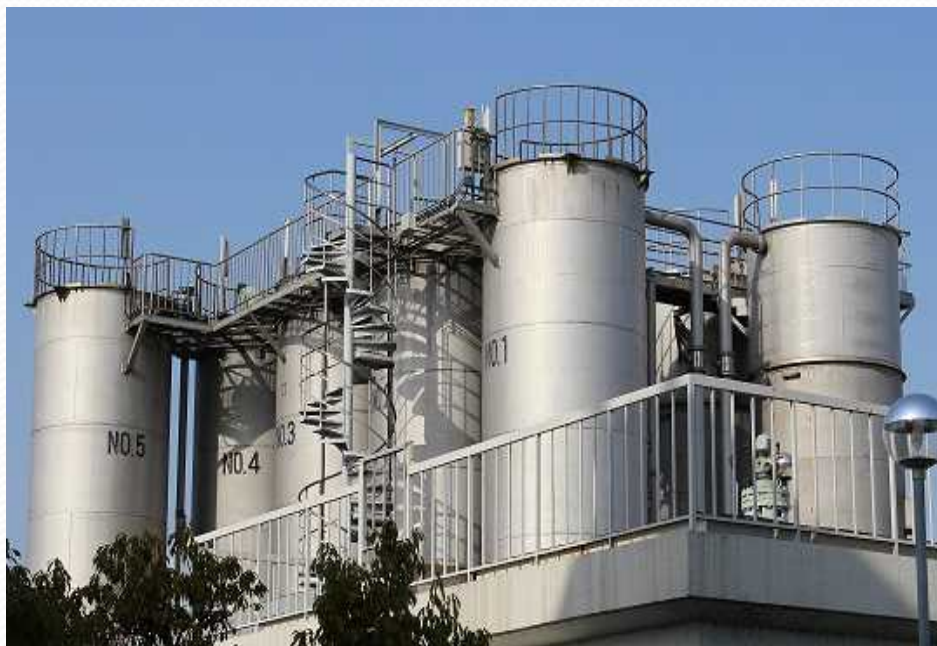
大冠浄水場のエアレーション設備
