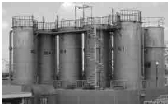
エアレーションタワー
