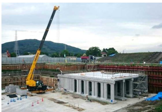
雨水貯留施設（安満遺跡公園内）
