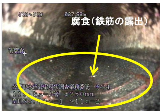
腐食（鉄筋の露出）
