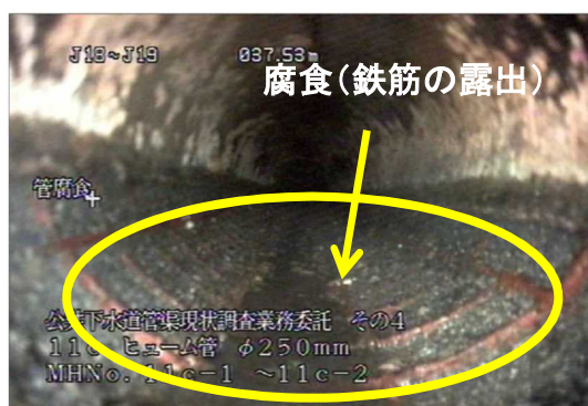
腐食（鉄筋の露出）
