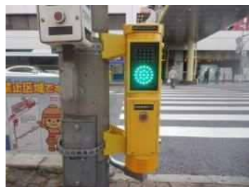
LED付き音響信号の設置
