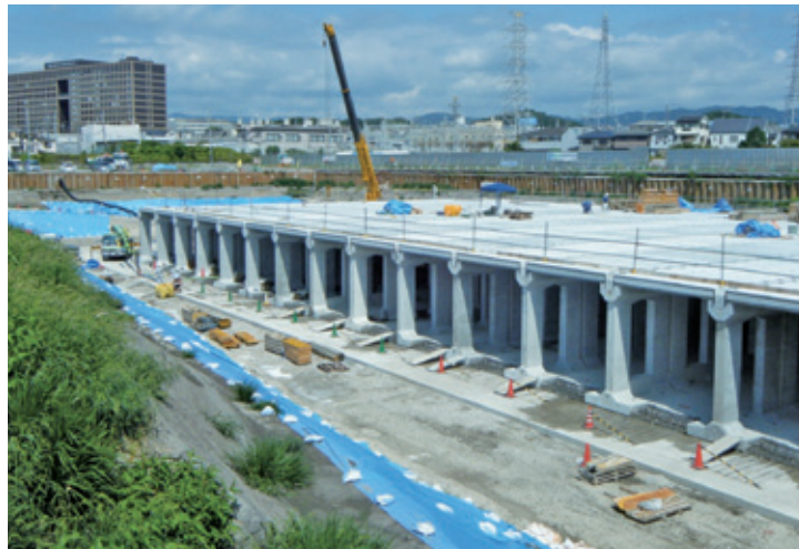
<雨水貯留施設> 集中豪雨の際、雨水を一時的に貯留し、浸水被害を軽減。安満遺跡公園、高槻城公園内に整備
