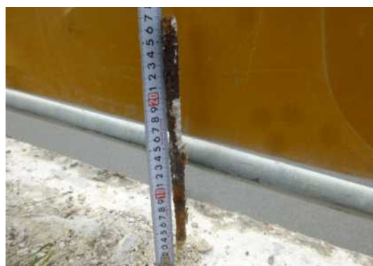
接合筋が溶接されていない
