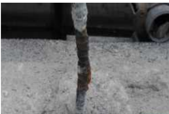
接合筋の腐食
