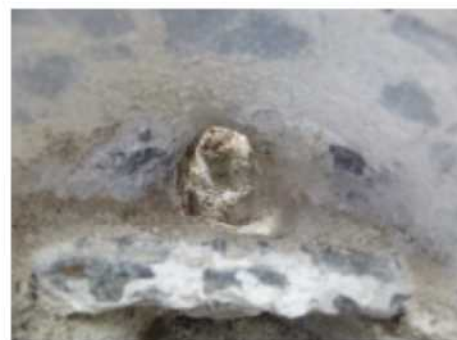
【16】近景 接合筋抜け出し
