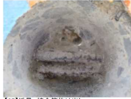
【27】近景 接合筋抜け出し
