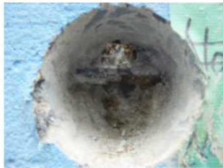
【34】近景 接合筋抜け出し
