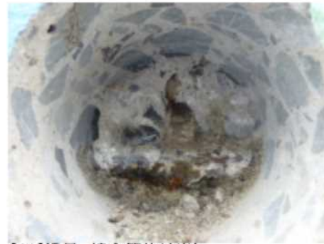
【31】近景 接合筋抜け出し
