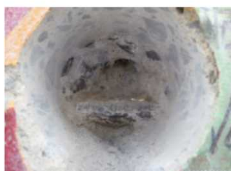
【26】近景 接合筋抜け出し
