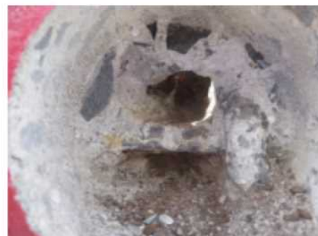
【19】近景 接合筋抜け出し
