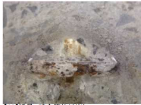
【23】近景 接合筋抜け出し
