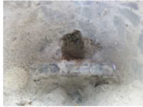
【9】近景 接合筋抜け出し
