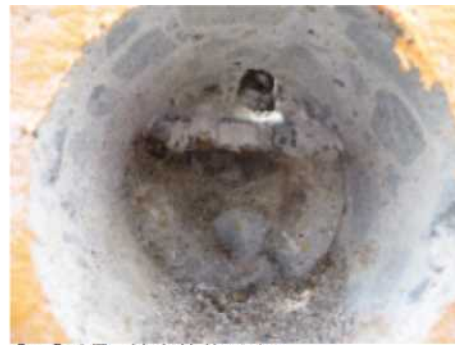
【29】近景 接合筋抜け出し
