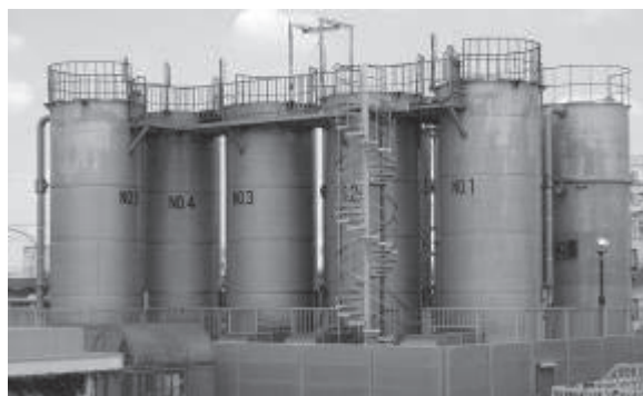
エアレーションタワー
