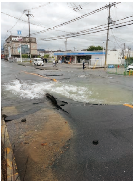
下田部町二丁目付近などで、市が水道水の供給を受けている大阪広域水道企業団の水道管が破損し受水が停止したことで、市内の半分以上の地域で、断水・濁り水が発生した(6月18日)
