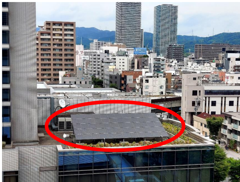
図 建物の屋上に設置された太陽光発電施設 (高槻市総合センター)
