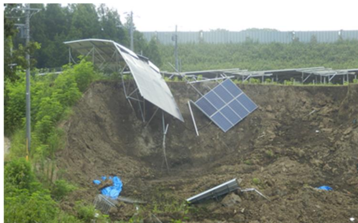
図 大雨による崩落事故
