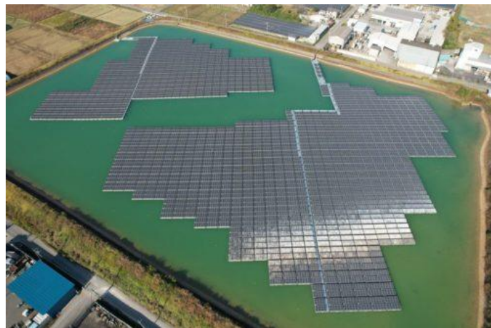
図 ため池に設置された太陽光発電施設 (出典：環境省)
