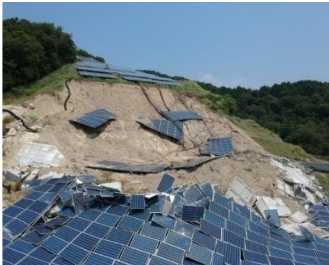
図 平成30年の西日本豪雨による太陽光パネルの損傷事例 出典：経済産業省
