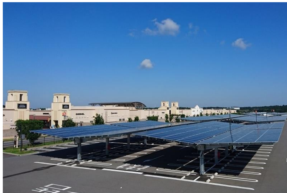
図 カーポート型太陽光発電所 (酒々井プレミアム・アウトレット)
