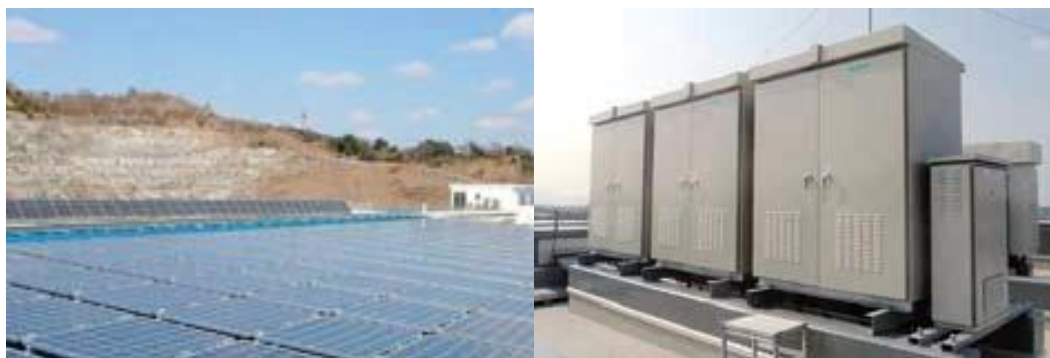
図 太陽光パネルとパワコン
