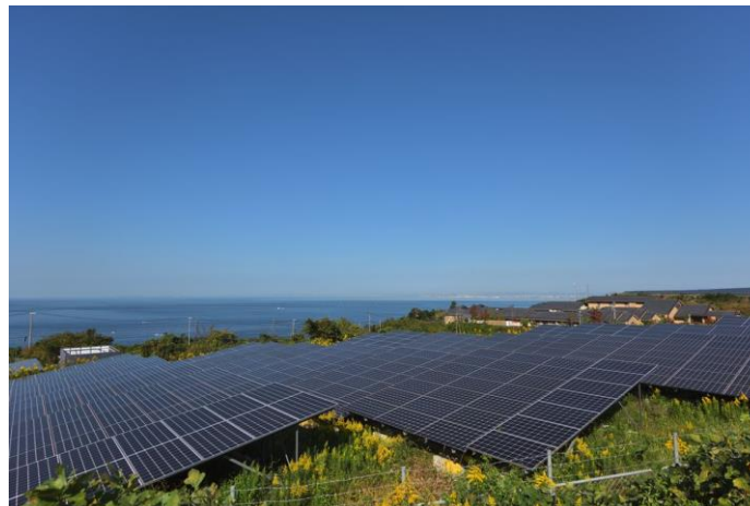
図 遊休地に設置された太陽光発電施設 (出典：環境省)
