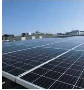
太陽光発電システム
