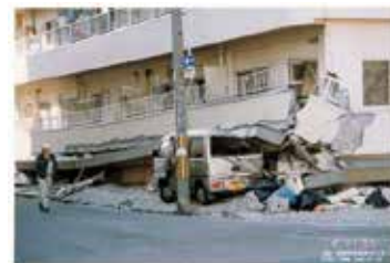
阪神大震災で倒壊したマンション (写真出展：災害写真データベース)
