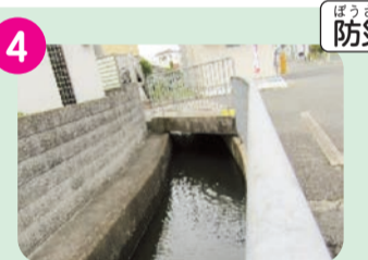
4 防災 雨が降ると水位が上がり やすい。普段から近寄らない。 校区内には水路がたくさん あり、同様に危険なので入ら ないようにする。
