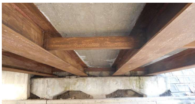
〔損傷〕腐食・防食機能の劣化
