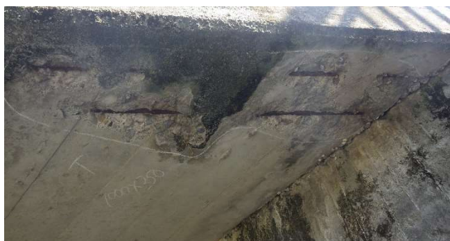
〔損傷〕床版の剥離・鉄筋露出
